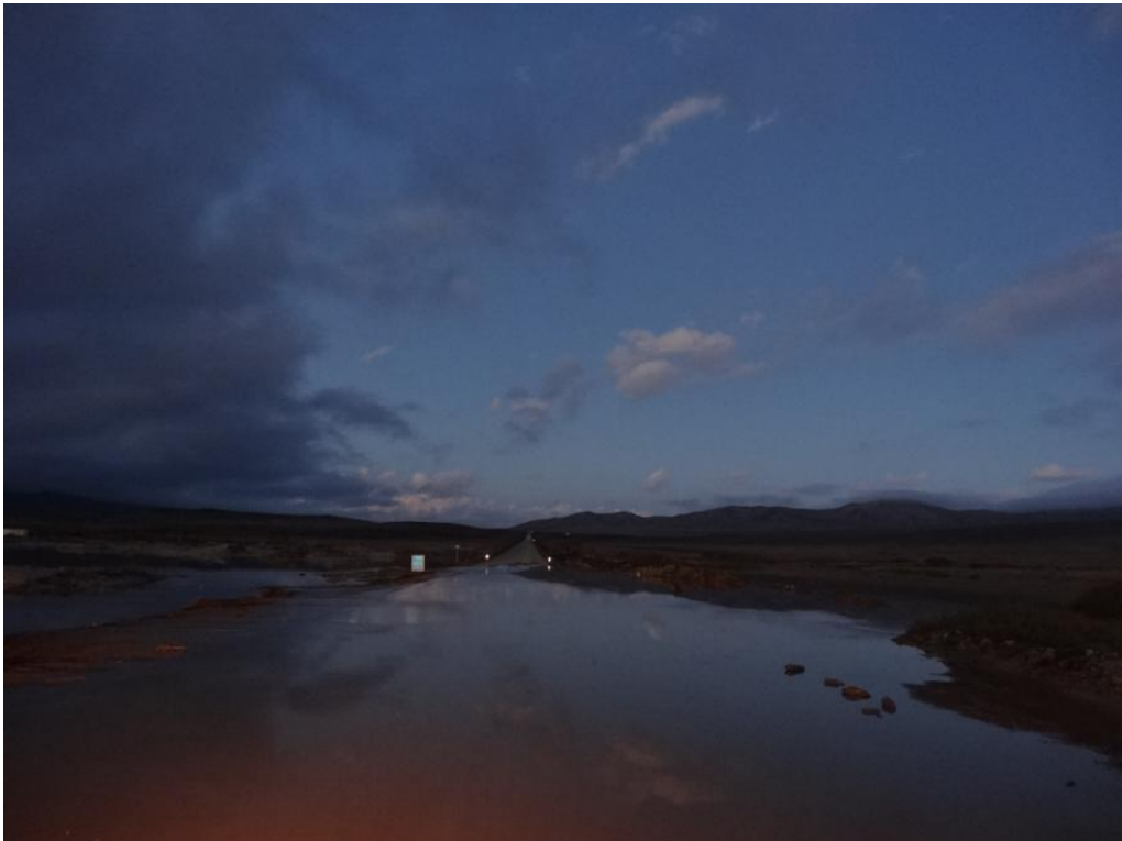
Fig. 3. Badén en ruta 5 con acumulación de agua y sedimentos de hasta 15-20 cm de espesor.
